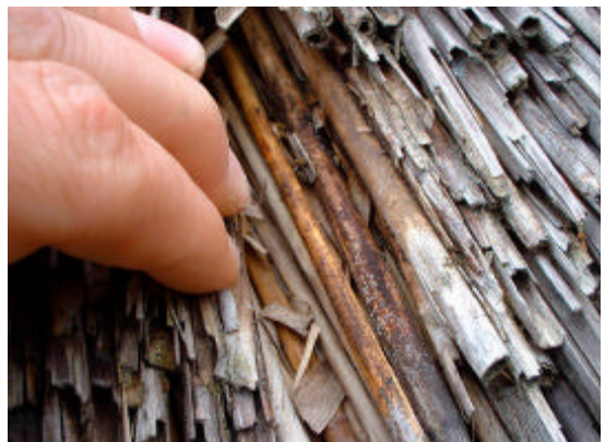
Foto 11: Forvitring på grund af højere fugtighed i tagrør.
