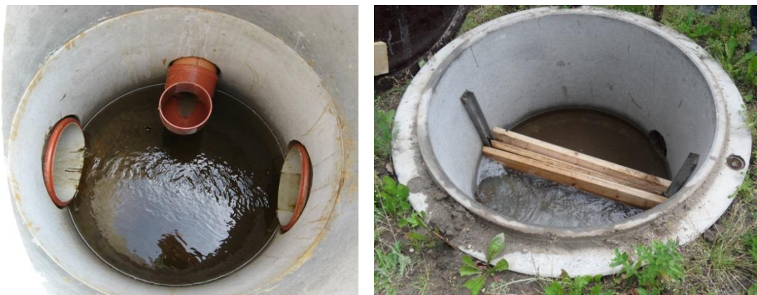
Figur 3. Foto af to typer fordelerbrønde med omløbsdræn (by-pass) etableret med hhv. rørbojning (a) og med svinerygsplanker (b). Foto: Charlotte Kjærgaard.
