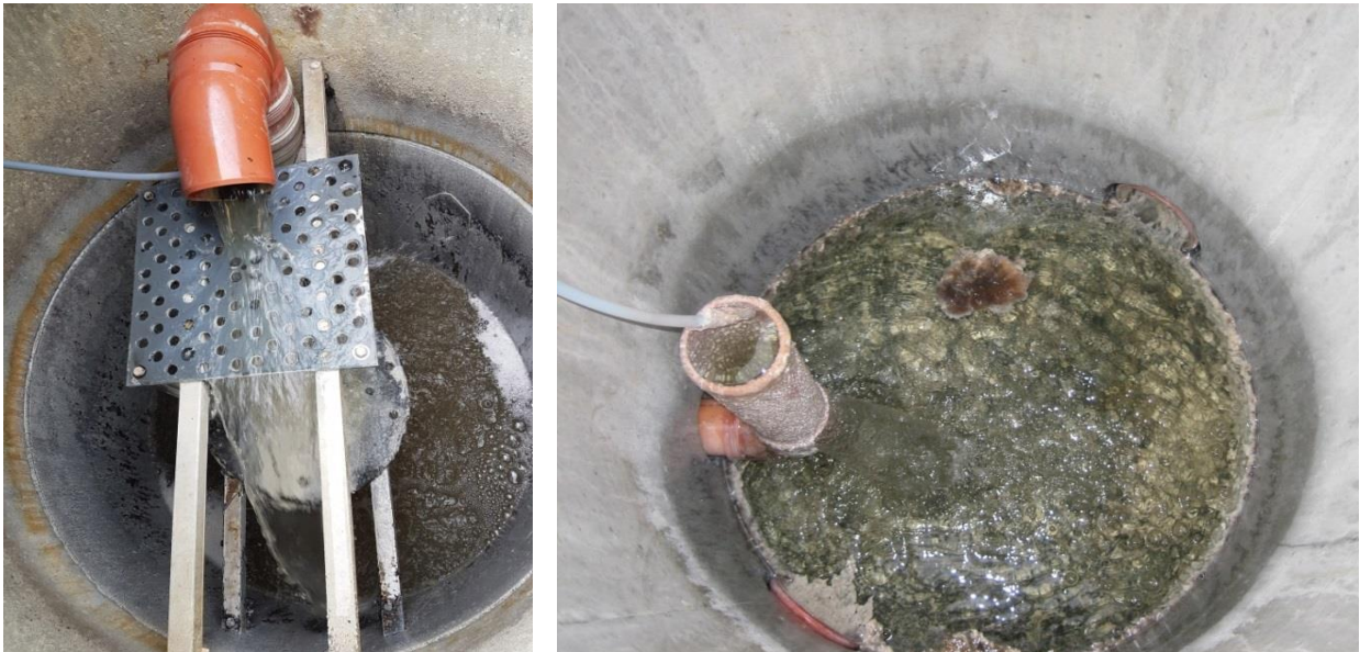
Figur 15. Eksempler på to typer af iltningsbrønde hhv. (a) brønd med en eller flere perforerede plader der øger iltningen af vandet. Bemærk at iltningspladen på det viste foto ikke er stor nok, og en del af vandet passerer forbi første og især anden plade. Der bør derfor anvendes iltningsplader der dækker størstedelen af brønddiameteren, og (b) lodret rør hvor vandet iltes når det plasker ned i bunden af brønden. Det anbefales at anvende iltningsbrønd med flere perforerede plader , hvor første iltningsplade kan etableres lige under rørudløbet som vist på foto (a). Fotos: Charlotte Kjærgaard.
