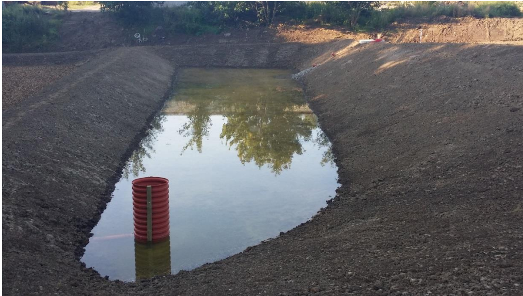
Figur 4. Foto af nyetableret stuvningsbassin til en filtermatrice. Foto viser stuvningsbassinet ved lav vandstand. Stuvningsbassinet er etableret frit drænløb (bagerst th). Udløbet sker via det vertikalt opslidsede stuvningsrør (forrest tv). Drænvandet siver gennem det opslidsede stuvningsrør til et vinklet udløbsrør, der via et horisontalt rør (ses som rørføringen under vandspejlet) leder vandet til fordelerdrænet i filtermatricen. Vandspejlet kan her stige 0,5 m mellem laveste og højeste vandkote. Stuvningsbassinet er konstrueret med længst mulig afstand mellem ind- og udløb. Foto: Charlotte Kjærgaard.
