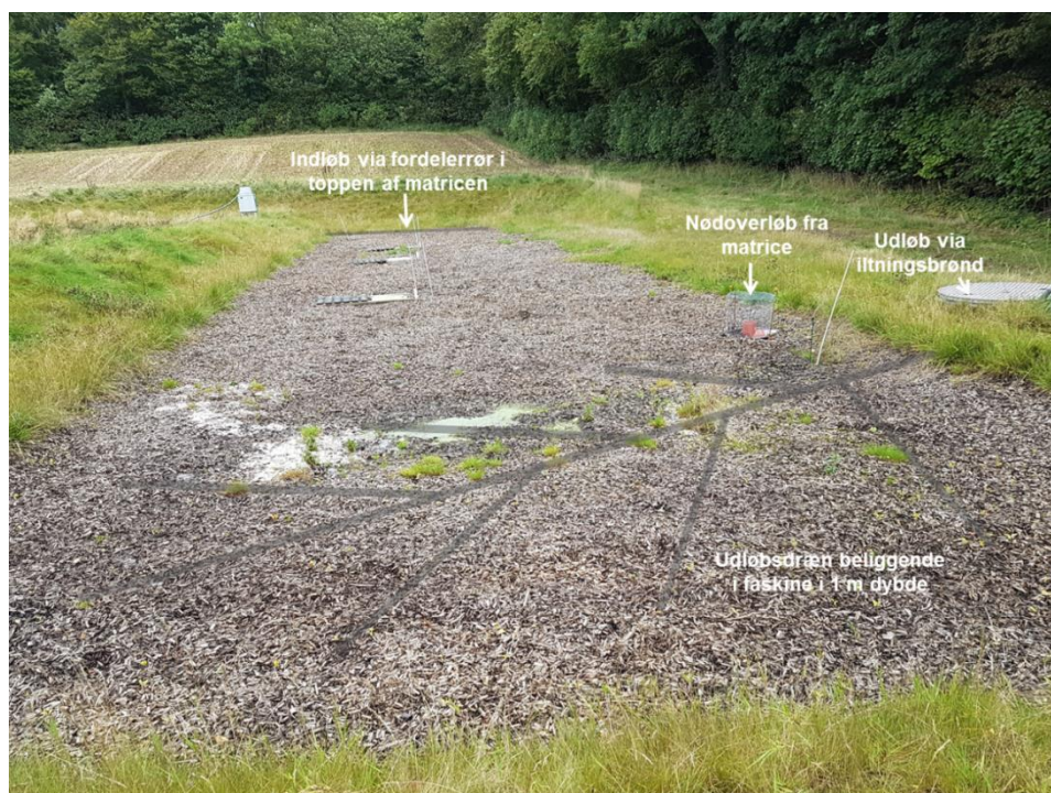
Figur 14. Filtermatrice (31 m lang og 8 m bred) med angivelse af indløb i form af tildækket fordelerrør (bagerst på foto) og i udløb via det forgrenede opslidsede/perforede udløbsdræn beliggende i 1 m dybde markeret. Udløbsdrænet afvander via en lukket rørføring over en iltningsbrønd, hvor vandet er fritløbende. På foto ses også nødoverløb med kote 10-15 cm over den umættede fliszone, der kan aktiveres i tilfælde af ekstreme nedbørshændelser eller hvis udløbsdrænet midlertidigt tilstoppes. Foto: Charlotte Kjærgaard
