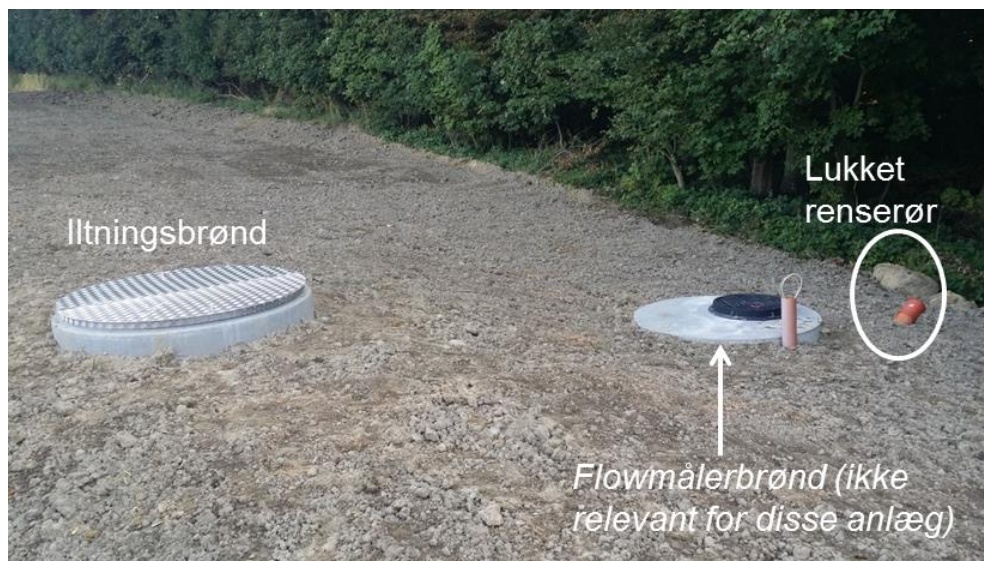
Figur 14. Foto af iltningsbrønd og det lukkede renserør (orange rør) der begge er placeret i skråningsanlægget. Foto: Charlotte Kjærgaard.
