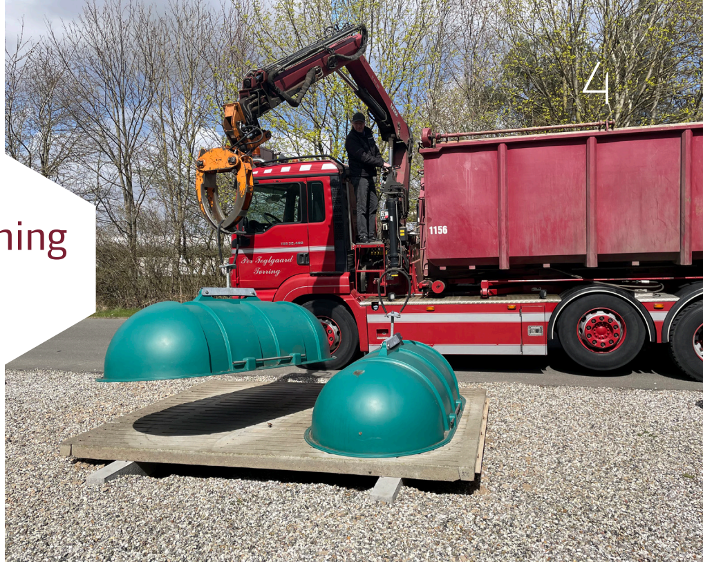
En god afhentningsplads har fast underlag og intakt kappe. Foto: DAKA
