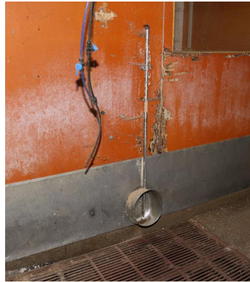
Figur 20: Grisene havde gnavet i væggenes samlinger samt over stålpladerne. Væggene burde have været beskyttet op i 70 cm højde.
