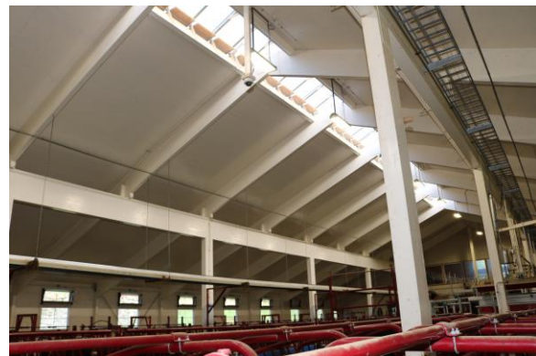
Figur 11: Kostald med spær og åsetræ af limtræsdragere. Indvendig loftbeklædning af krydslamineret træ, tre lag.
