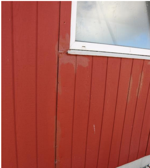
Figur 19: Tegn på råd ved vinduer pga. vand fra sålbænke.
