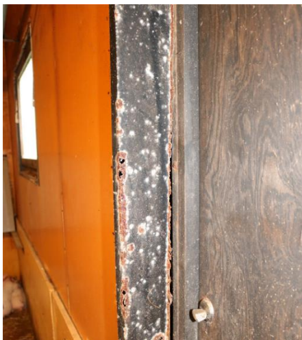
Figur 16: Metalinddækninger ved dørkarme, som var begyndt at ruste.
