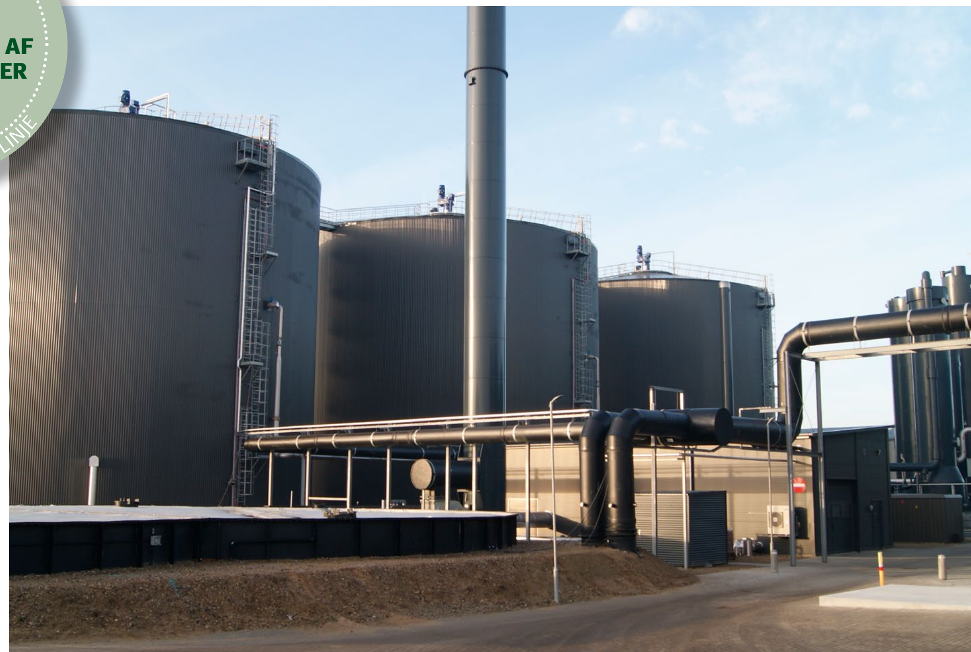
Biogasanlæg. Foto: Erik Fog.
